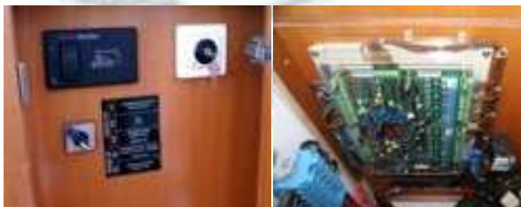
La placa electrònica controla conjuntament amb el variador de cadascun dels motors els paràmetres elèctrics del sistema. El commutador de 5 posicions permet definir el mode de funcionament de l'energia del vaixell. En un dels cofres exteriors es troba còmodament instal·lat el generador diesel que alimenta tots els sistemes de Lagoon 420 Hybrid.
